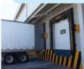
Equipamiento de Andén
