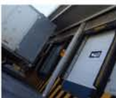
Equipamiento de Andén
